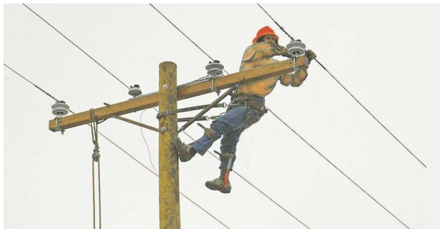
Hình 79: Nguy cơ tai nạn điện giật
